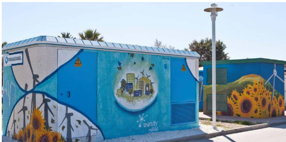
Sottostazione automatizzata dimostrativa
