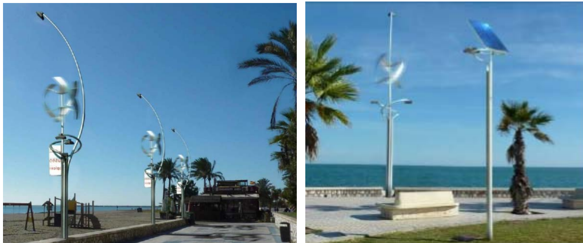
Installazioni di illuminazione pubblica alimentate da energia solare ed eolica
