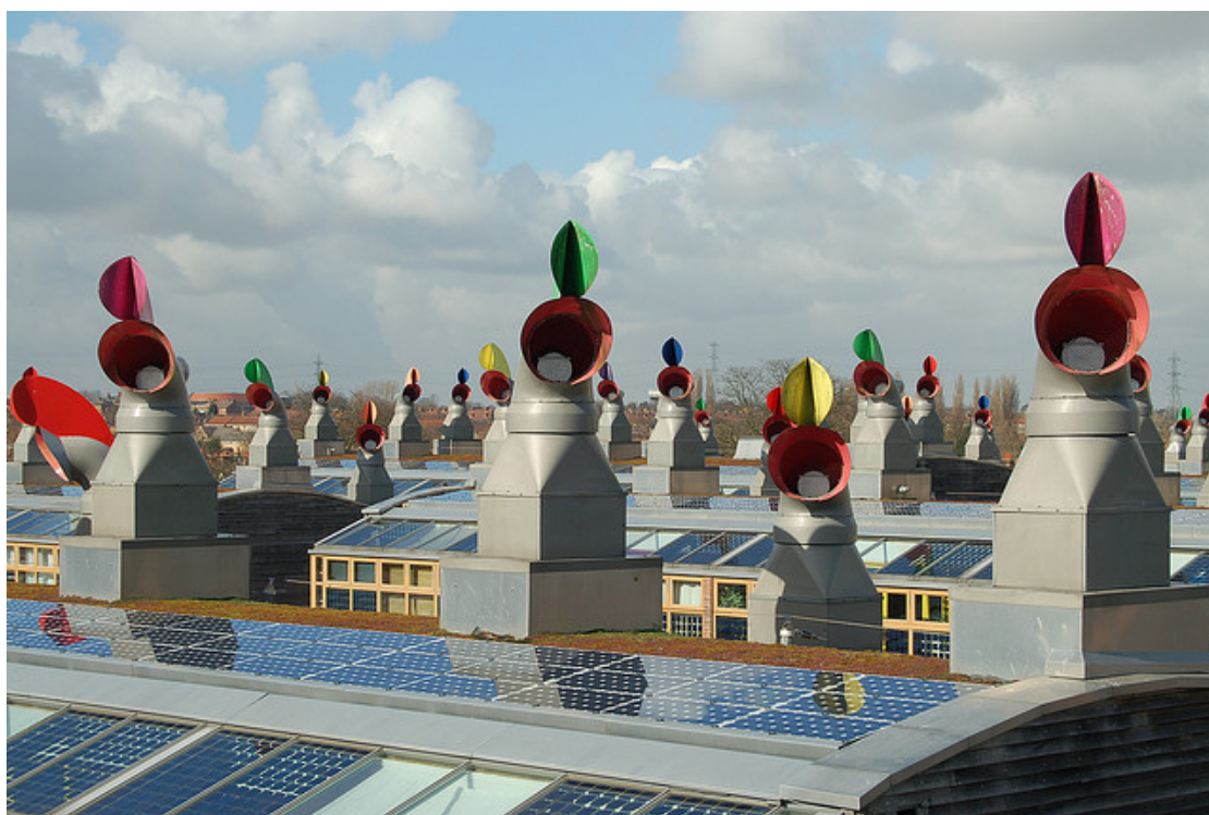
Camini a vento e tetti fotovoltaici
