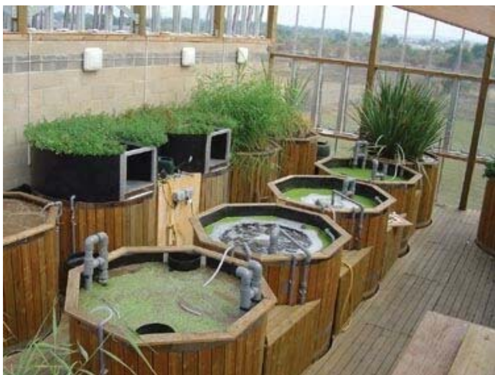
Cisterne e sistemi di depurazione
