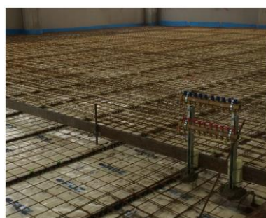
Particolare del tubo di riscaldamento
